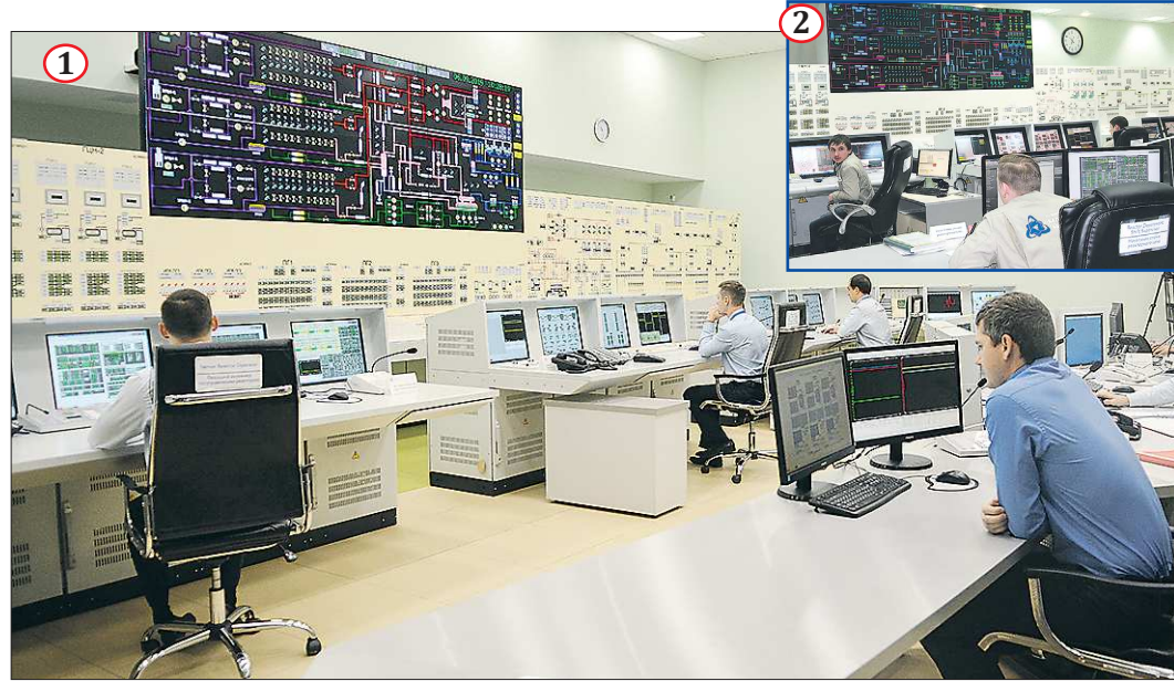
Тренажер БН-800 (фото №1) идентичен реальному пункту управления энергоблоком (фото №2). Повторяются состав и расположение экранов, рабочих мест операторов с телефонными аппаратами и компьютерными мышками. Здесь даже стены окрашены в тот же цвет
