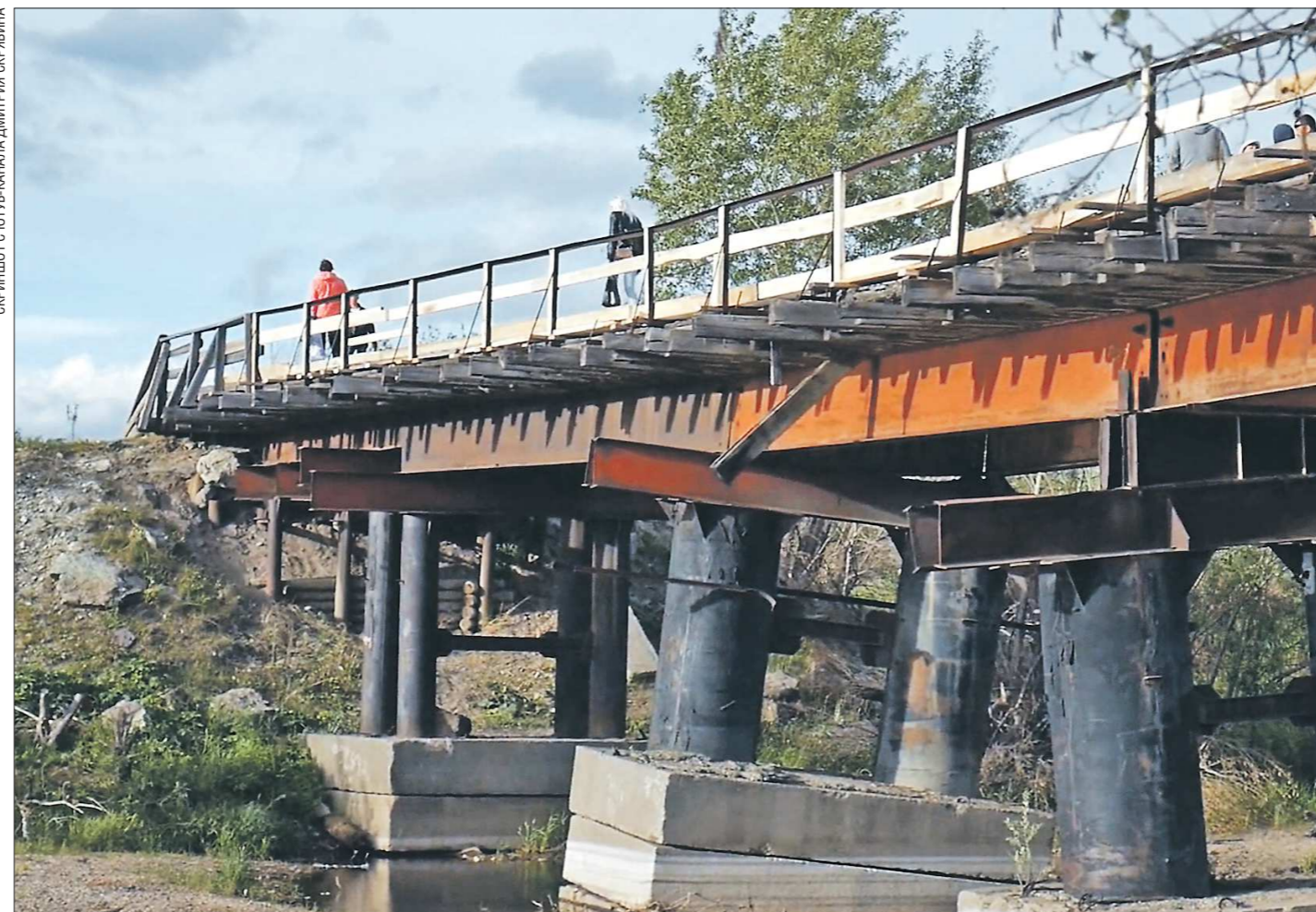
Серовчане своими силами также сделали новые ограждения, пешеходную дорожку. Теперь по мосту можно безопасно передвигаться. Однако на фото видно, что опоры моста явно нуждаются в ремонте...
