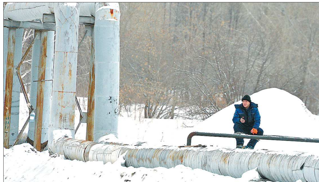
Часть магистральной теплоцентрали в Сухом Логе проходит прямо по земле, диаметр трубы - 500 мм, общая протяжённость - около 3 км
