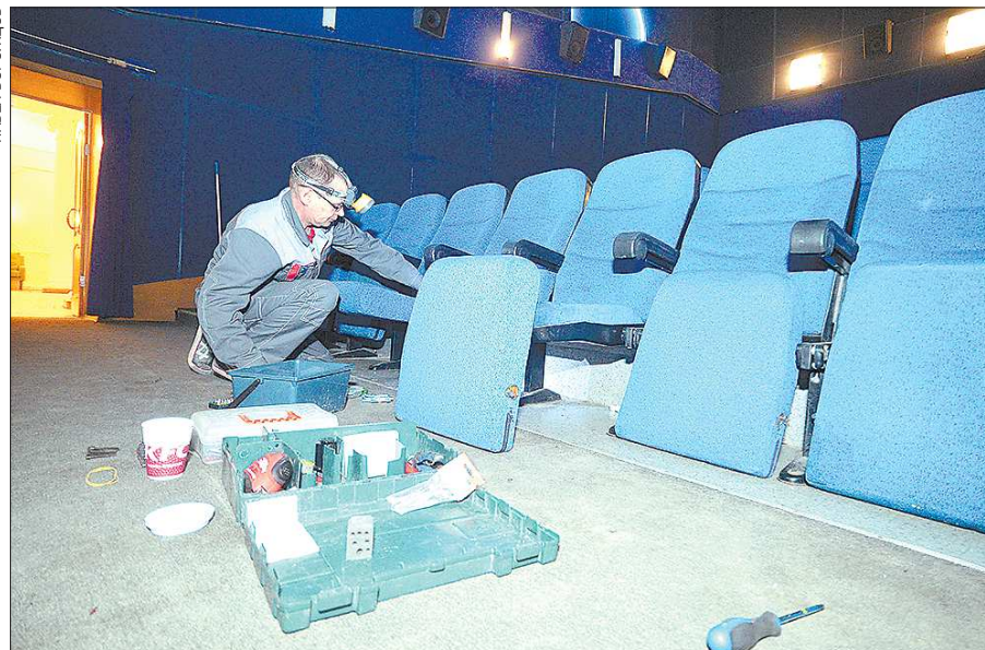
Пока здание закрыто от посетителей, в нём ведутся работы, например, проводится ремонт кресел в кинозале
