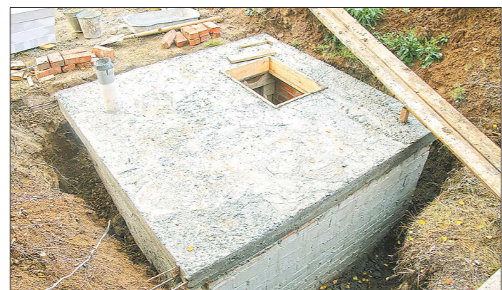
Примерно так может выглядеть отдельно стоящий погреб. Здесь грамотно установлены трубы вентиляции – они стоят в разных углах
