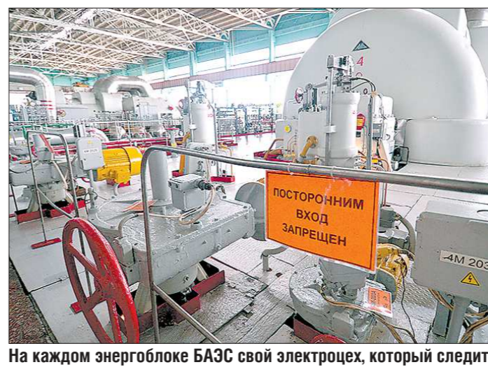
На каждом энергоблоке БАЭС свой электроцех, который следит за всем электрооборудованием от генераторов до релейной защиты
