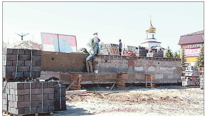
В скором времени артёмовцы получат двухэтажное здание с кассами, залом ожидания, кафе и даже спортзалом
