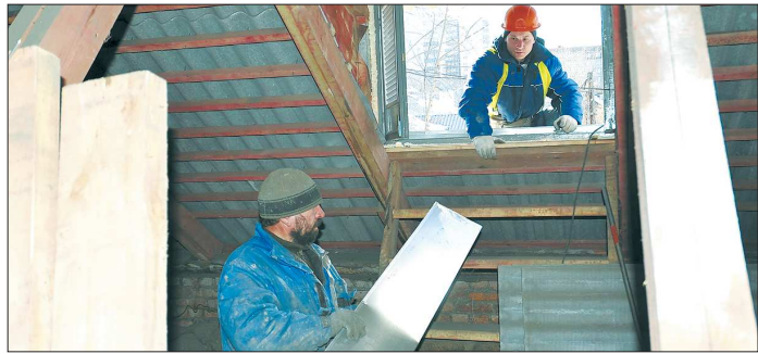
От всевидящего «Ока» теперь не скрываются ни на одном объекте: за ходом капремонта следят в режиме реального времени
