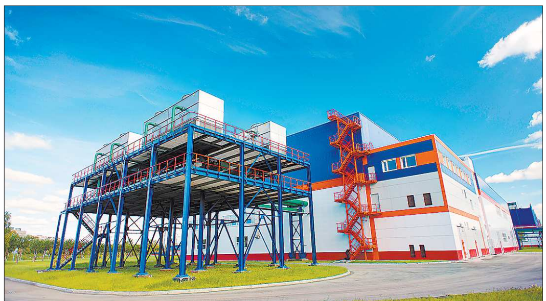
Современный блок очистных сооружений трубопрокатного цеха СТЗ
