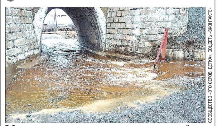
В Серовском городском округе затопило дорогу к посёлку Красноярка, расположенную под железнодорожной насыпью.
