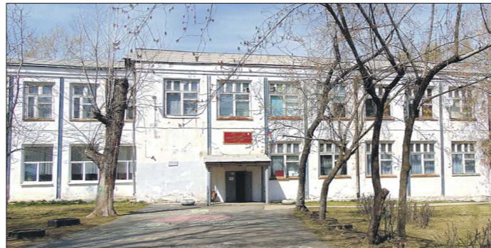
Пусть вас не обманывают эlegantные фасады здания 1926 года постройки. Во второй Кировградской школе «гуляют» стены, они стянуты балками. Состояние постоянно отслеживают специалисты
