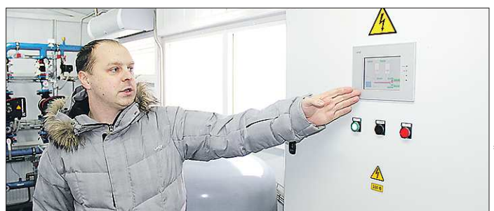
Главный инженер МУП «Тепловые сети» Сергей Воронин указывает на данные работы котельной, которые поступают не только в диспетчерский пункт, но и производителю оборудования в Чехии
