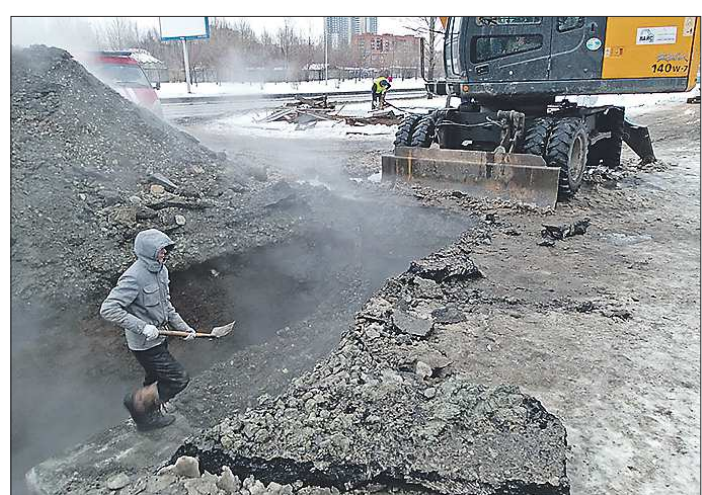
Из-за аварии на Таватуйской отопление убавили в 54 жилых домах, 5 детских садах и одной школе. Специалисты посчитали, что во время потепления на улице помещения не успеют остыть
