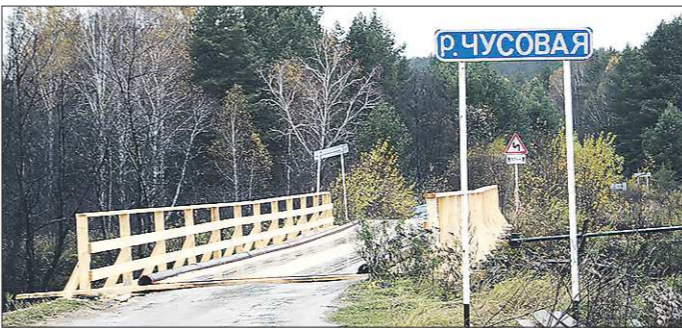
Длина моста — 22 метра, ширина — шесть. Последний ряд мостов отремонтировали в 1981 году, к тому же средства местных жителей
