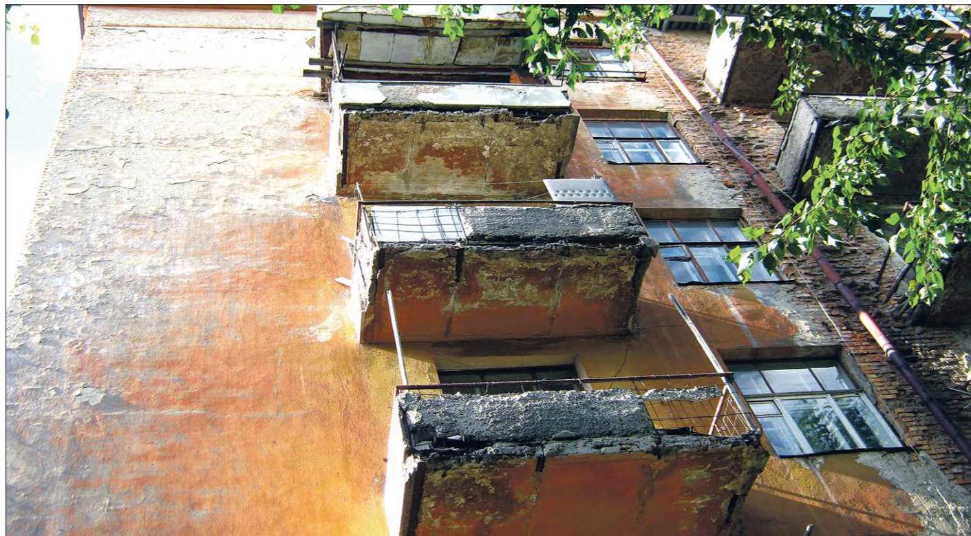
Этот расселенный дом, находящийся в Екатеринбурге по адресу Чапаева, 14/4, должны были снести ещё в прошлом декабре
