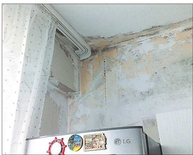
Сырость атакует жильцов с крыши и из подвала, который накануне публикации неожиданно закрыли на замок
