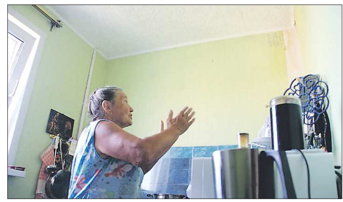
На последний ремонт Альфица Яхина потратила 7,5 тысячи рублей, но стена снова почернела уже через неделю
