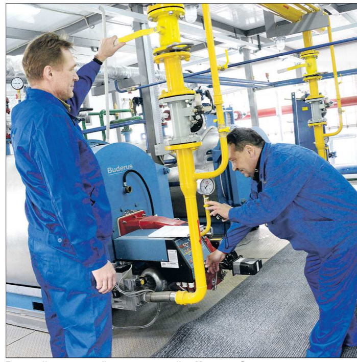
В новой котельной, построенной в Нижних Сергах в рамках пилотного проекта, идут пусконаладочные работы, которые завершатся к началу отопительного сезона
