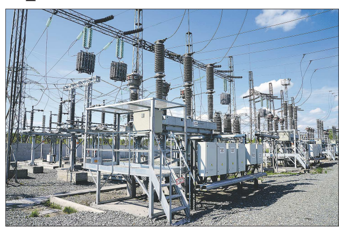
Подстанция «Ферросплав» в день пуска
