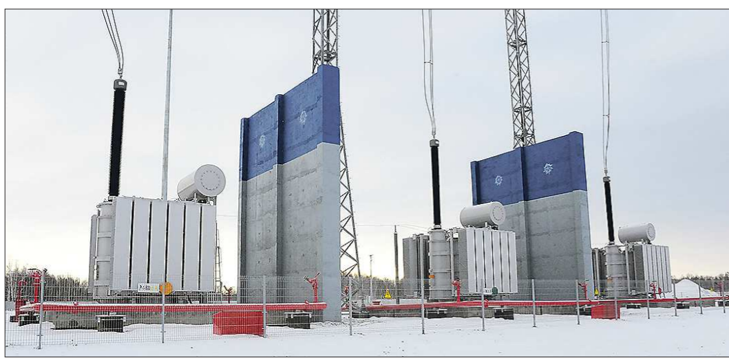
Современные подстанции компактны, просты в эксплуатации и надёжны
