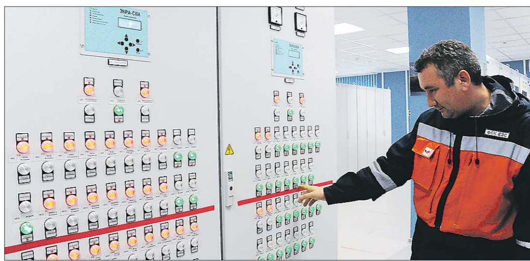
Штатная проверка работы оборудования. Всё исправно. Электроэнергия идёт к потребителям
