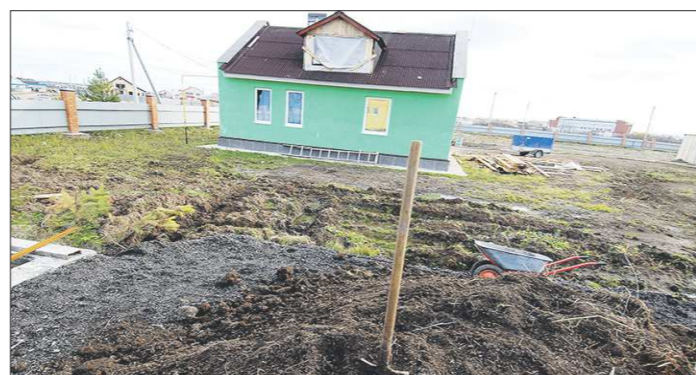
Немалое количество готовых домов по документам числится незавершённым строительством
