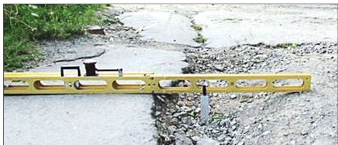
Пока тротуар не ремонтируют, жителям Талицы предлагают переходить на другую сторону: там с асфальтом всё в порядке
