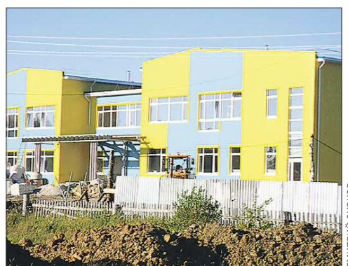
Новую школу на 154 места в селе Платоново планируют сдать к 1 сентября. Строительные работы подходят к концу
