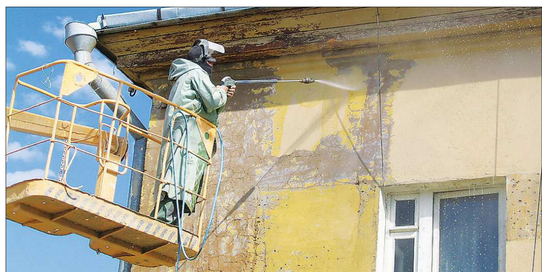
Износ жилого фонда страны — более 60 процентов. Косметическим ремонтом тут уже не обойдёшься
