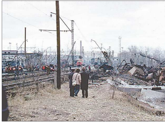
Воронка на месте взрыва была засыпана менее чем за сутки. Но движение через нечётную систему станции возобновилось только 7 октября. На снимке: рабочие укладывают рельсы по уже засыпанной воронке
