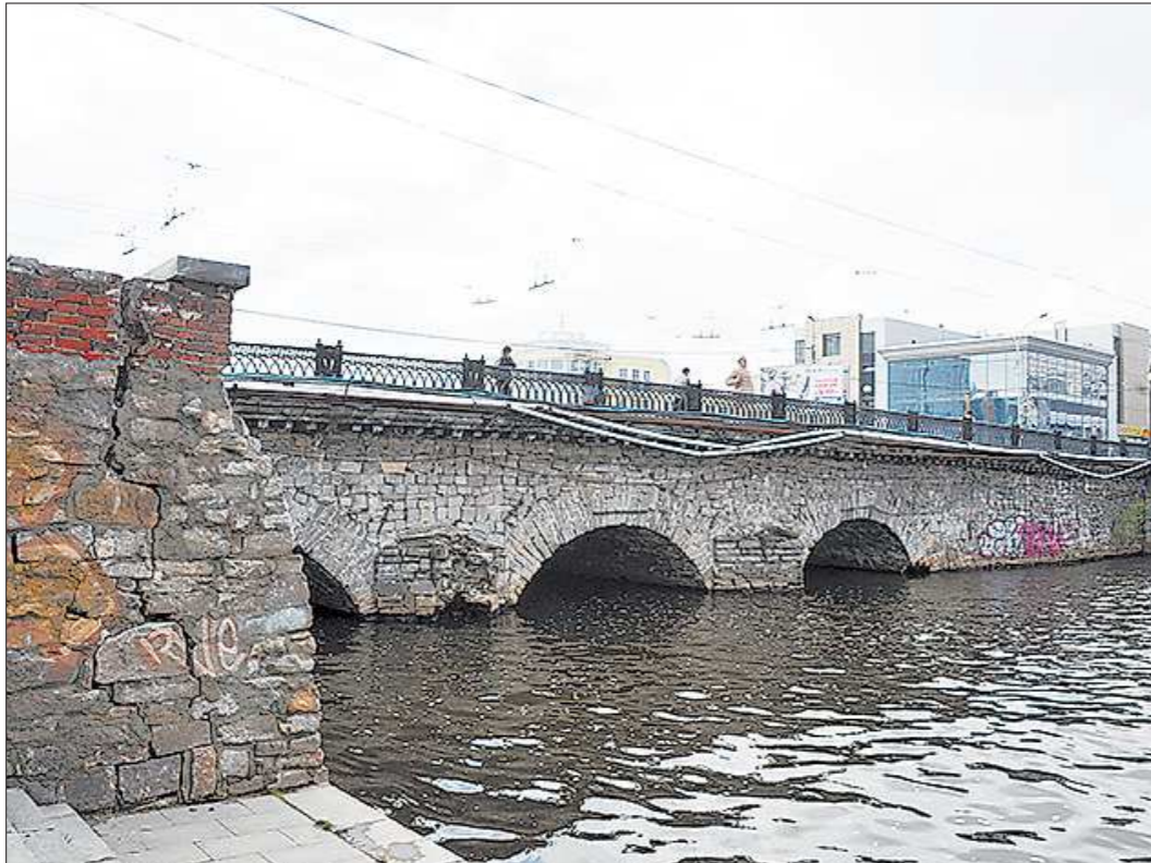
Под этим мостом на улице Малышева собираются прокладывать пешеходные дорожки. Есть надежда, что изменения затронут и непосредственно мост, рассыпающийся на глазах
