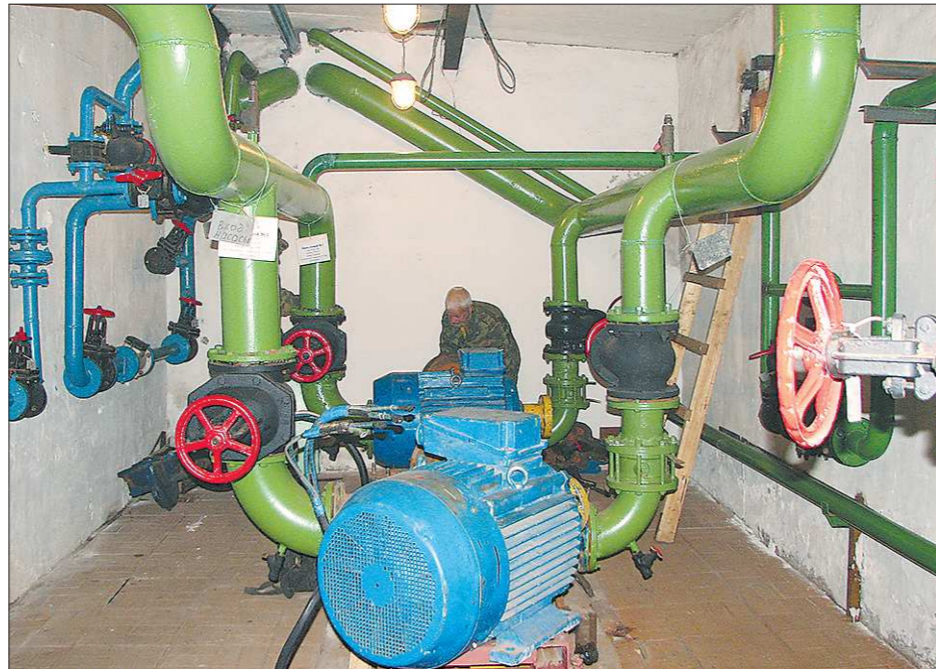
Громоздкие старые котельные — неоправданная роскошь для небольших городков. Первопроходцем в реформах системы теплоснабжения в управленческом округе является посёлок Баранчинский (на фото справа).
