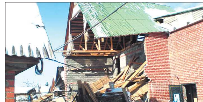
Рядом со старым бревенчатым домом хозяин строил двухэтажный кирпичный. В результате взрыва обрушились крытый двор и перекрытия нового строения, а старый при пожаре был повреждён огнём и восстановлению не подлежит
