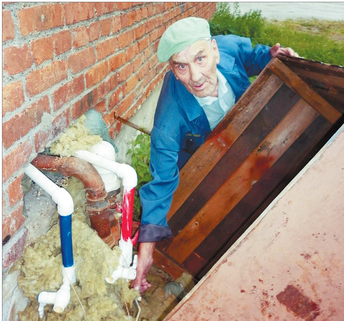
Борис Королёв демонстрирует плембу на отключённой задвижке. Здесь, у торца дома, температура воды в трубах соответствовала норме. Но по пути к квартирам существенно теряла в градусах...
