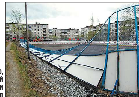
К счастью, от упавшей конструкции никто не пострадал
