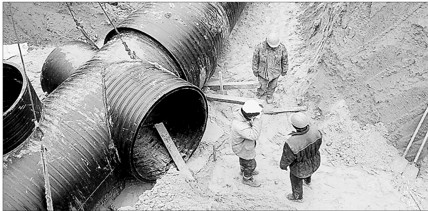
Длина трубопроводных сетей водопроводно-канализационного хозяйства России составляет около 700 тысяч километров. Фото из архива редакции
