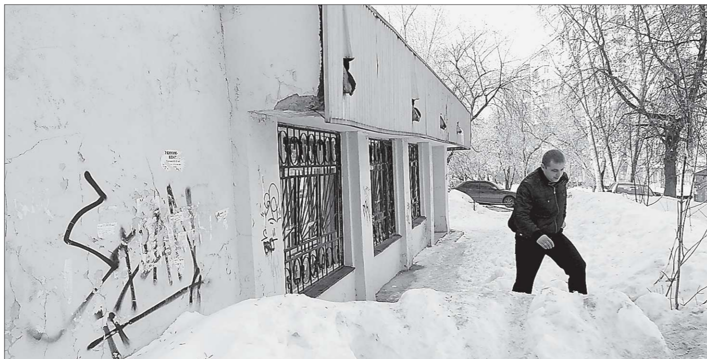
Управляющие компании зачастую ограничиваются только очисткой крыш от снега, забывая его вывозить. Фото Александра ЗАЙЦЕВА
