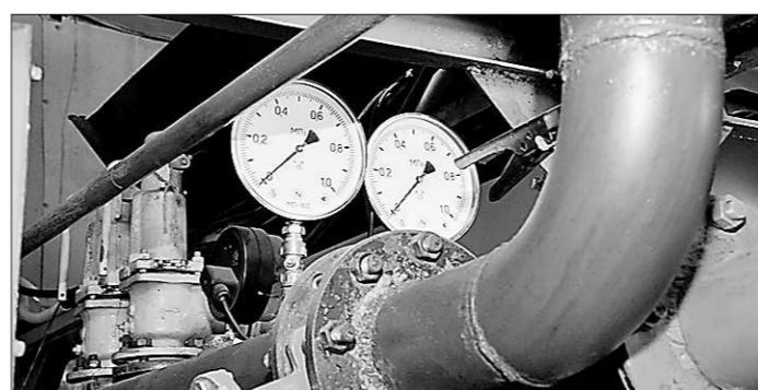
Манометры новой котельной на нуле уже много месяцев. Фото Алексея КУНИЛОВА
