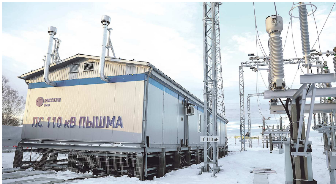
В ходе реконструкции подстанции использовалось исключительно отечественное оборудование и технологии
