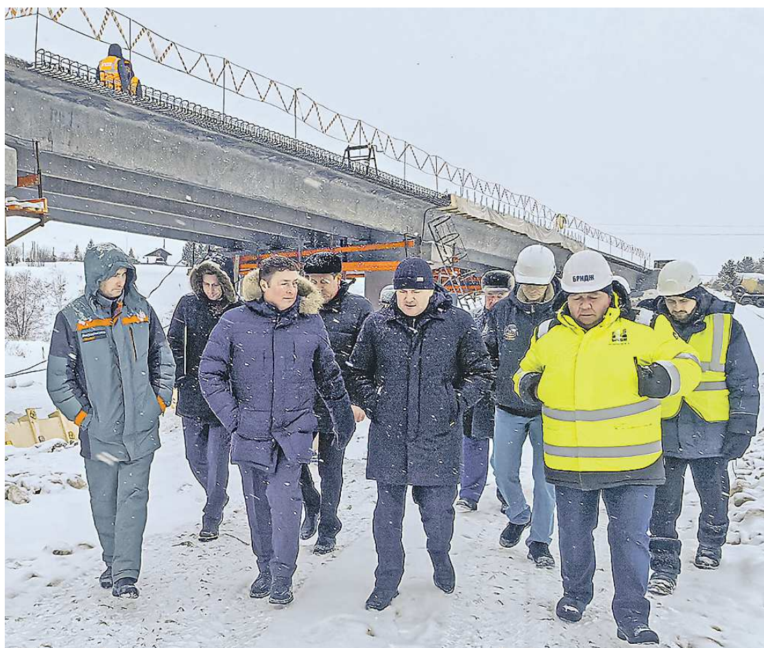
Строительство стратегически важного моста по поручению губернатора проинспектировал первый заместитель главы региона Алексей Шмыков (в центре)
