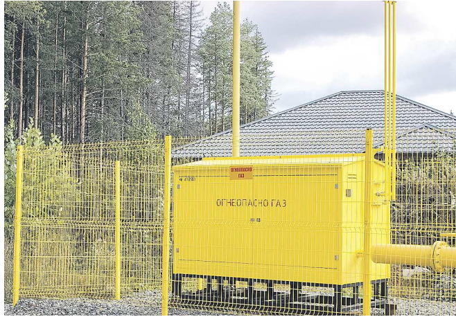
Газораспределительный пункт в г. Ревде
