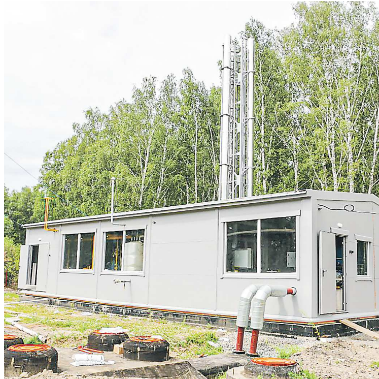
Новая котельная в селе Яр (Талица)
