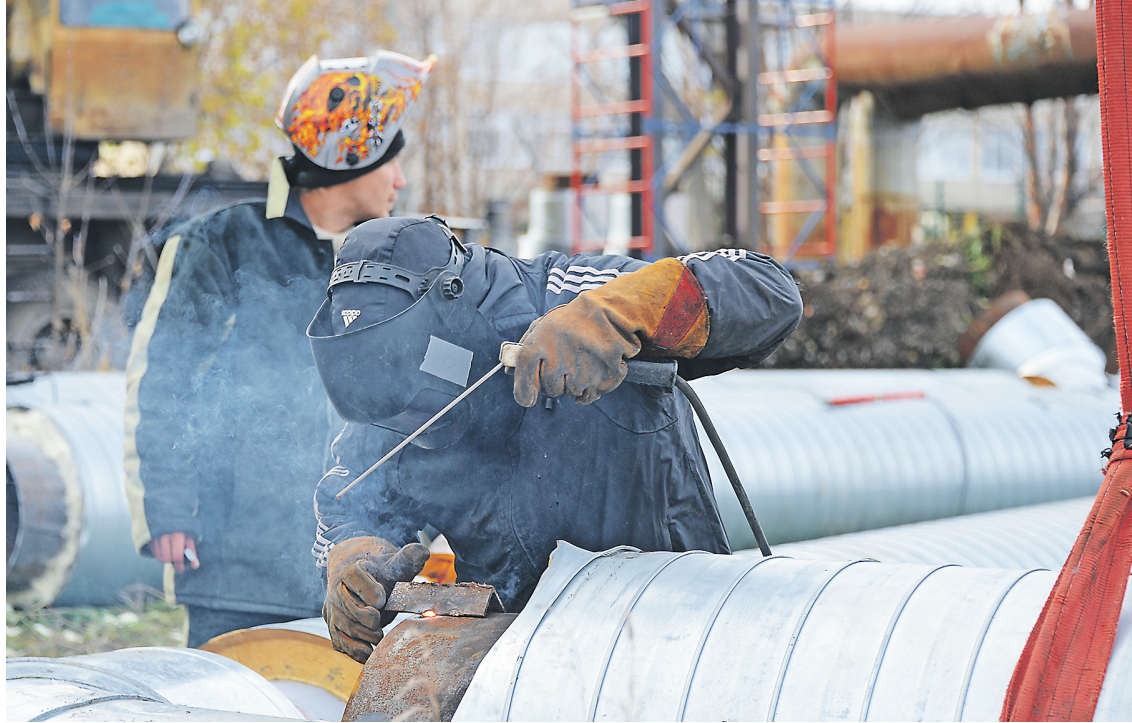
Все запланированные ремонтные работы находятся в завершающей стадии, их проведение не препятствует подаче тепла потребителям
