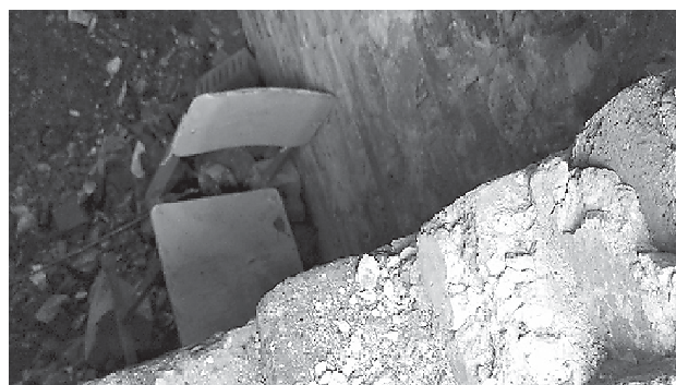
Фото 11-12. Полуразрушенное здание на заднем дворе Гимназии № 25, г. Ревда
