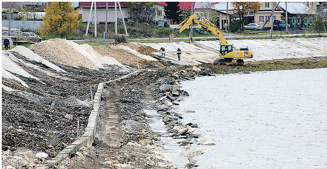
Плотина является стратегическим объектом, и фотосъемка ее ремонта требует специального разрешения. Строители укрепляют береговую линию вблизи сооружения
