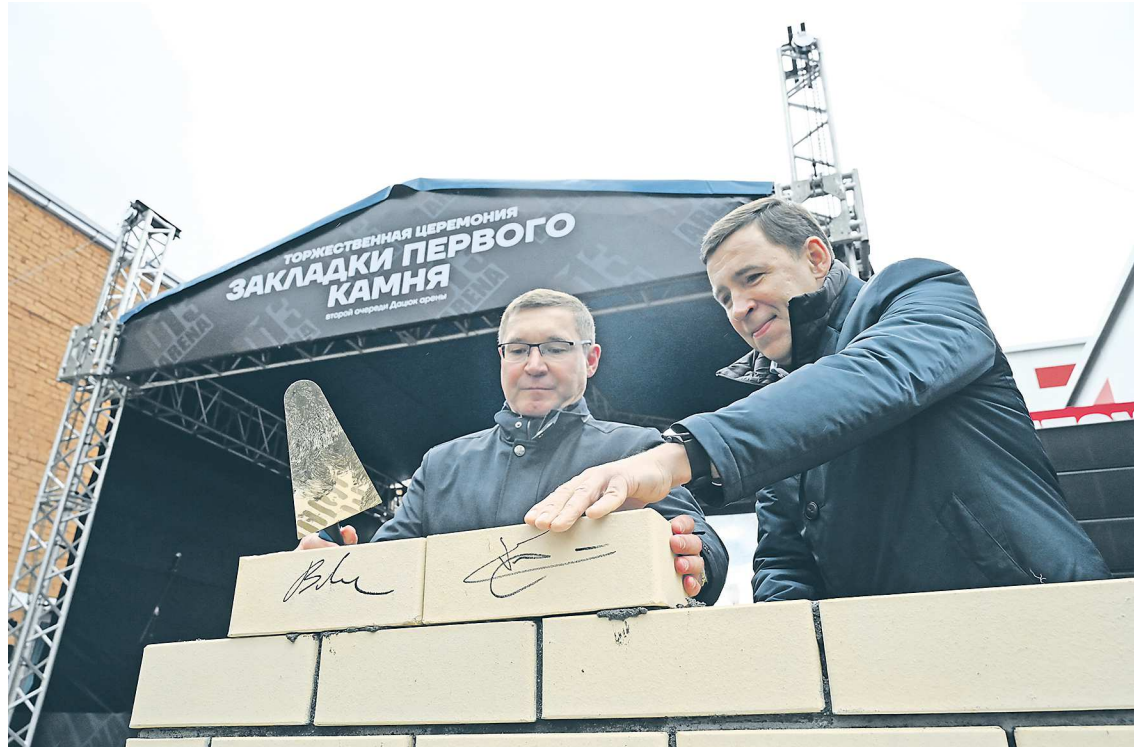
Полномочный представитель Президента РФ в УрФО Владимир Якушев и губернатор Свердловской области Евгений Куйвашев во время закладки первого камня в основание второй очереди «Дацюк Арены»
