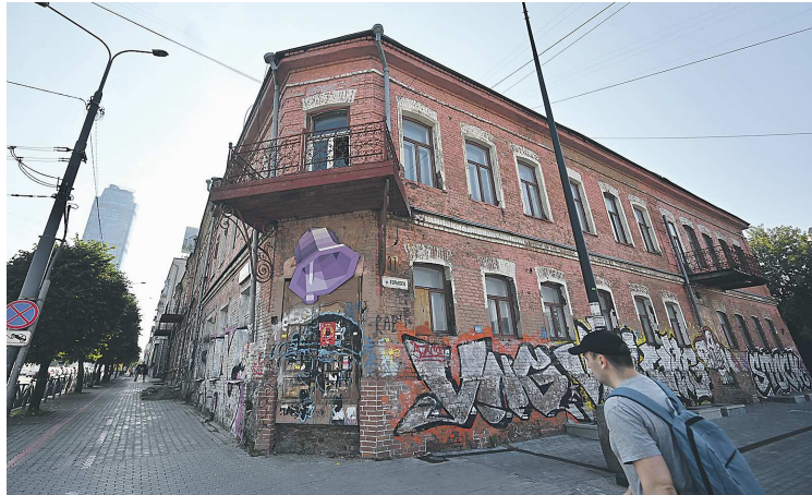
Сегодня здание находится в аварийном состоянии
