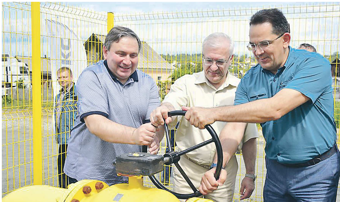
Областной министр энергетики и ЖКХ Николай Смирнов (слева), первый заместитель генерального директора АО «ГАЗЭКС» Игорь Логинов (в центре) и глава Краснотурьинска Александр Устинов запускают газовую сеть
