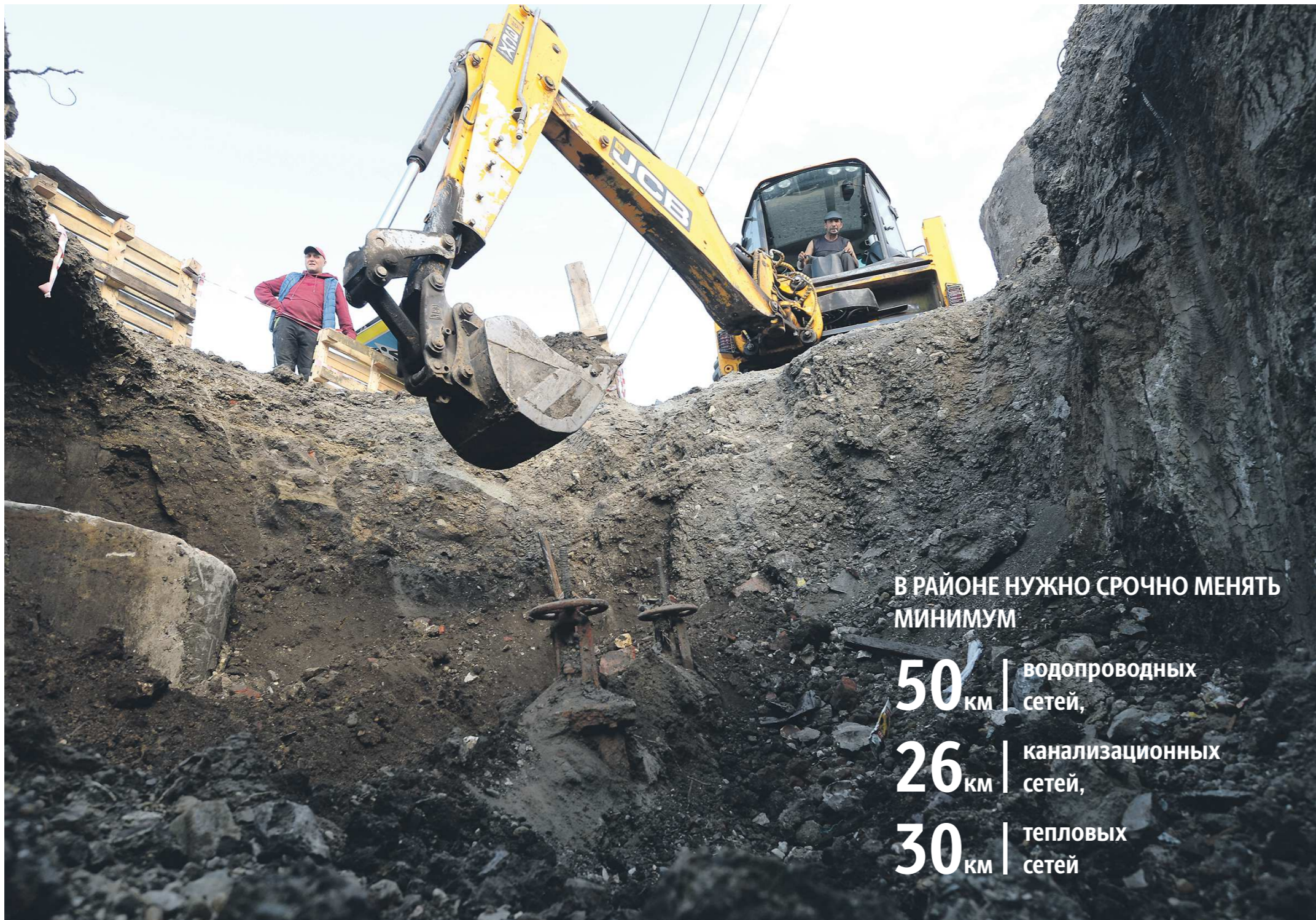
Под землей лежат трубы ещё с 1980-х годов, говорят коммунальщики. Они ржавые, все в трещинах – рассыпаются в руках
