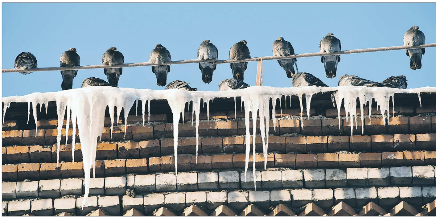
Постановление Госстроя №170 предписывает производить очистку крыш от наледи по мере её возникновения
