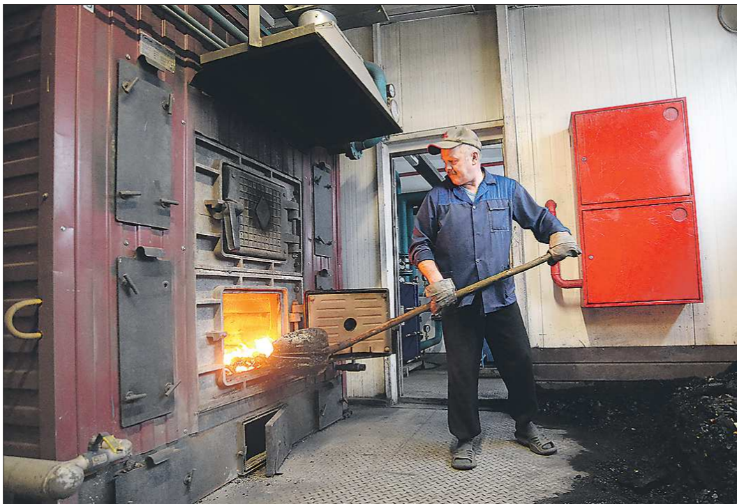
Кочегар Александр Тарасов в селе Александровском говорит, что новая топка в котельной намного безопаснее и экономичнее в расходе угля
