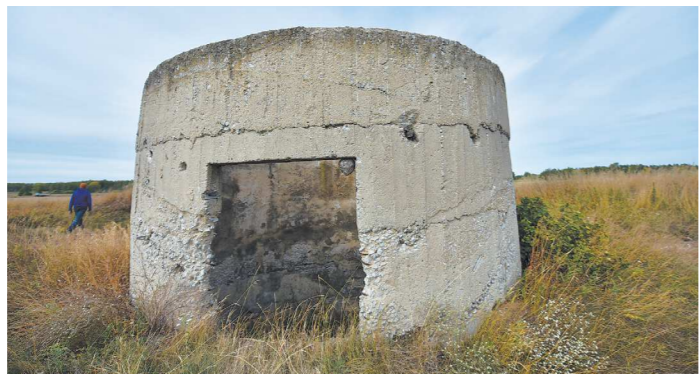
От силосной башни в селе Тыгиш осталось только бетонное основание, а чтобы спуститься на дно, понадобится высокая лестница или специальное снаряжение
