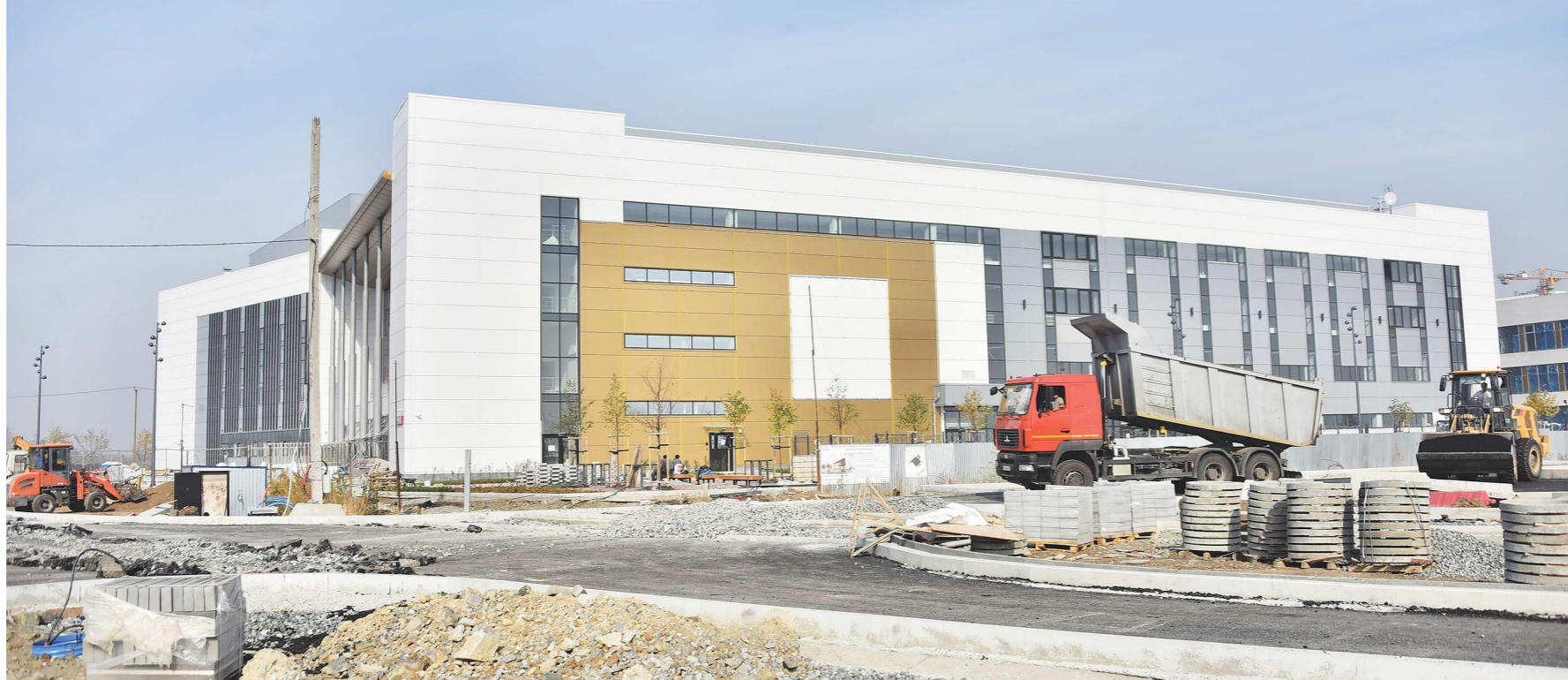
Центр художественной и эстетической гимнастики станет третьим по величине и оснащенности центром гимнастики в России, который спроектирован и построен по международным стандартам FISU. И крупнейшим на Урале и в Сибири. Площадь здания — 22 938 квадратных метров
