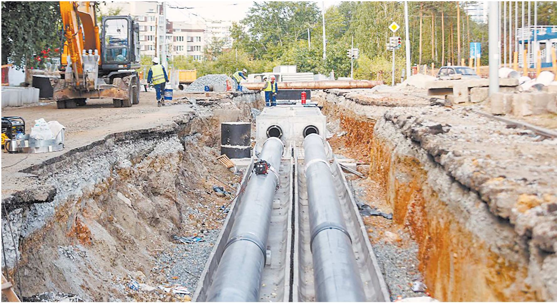
В Екатеринбурге прошли четыре этапа опрессовок, к зиме подготовлены более четырех тысяч многоквартирных домов и свыше двухсот объектов социальной сферы
