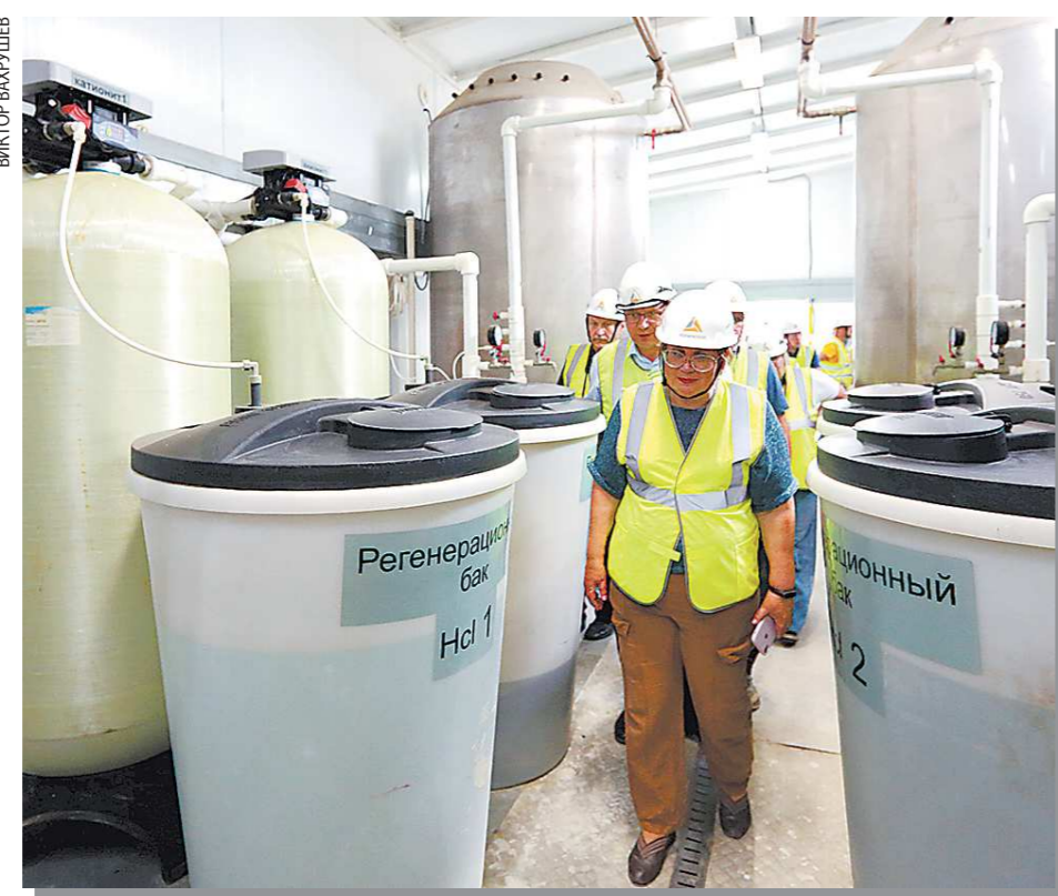
Татьяна Мерзлякова убедилась, что все параметры воды – до поступления в очистные сооружения и после – здесь строго контролируются, чтобы не допустить выброса в окружающую среду вредных примесей
